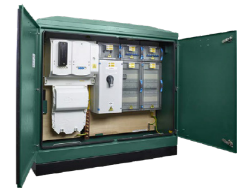
▲ EV feeder pillar.
